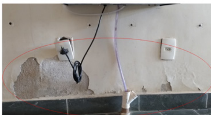
Figura 2. Metodologia adotada para contagem e qualificação das patologias de umidade acidental. FONTE: Os autores.
