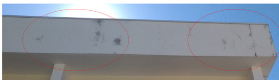
Figura 4. Metodologia adotada para contagem e qualificação das patologias de umidade de precipitação. FONTE: Os autores
