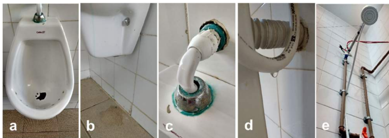
Figura 6: Equipamentos hidrossanitários avariados. Mictório com cubeta quebrada (a); mictório com fixação inadequada e vazamento (b); mictório com substituição inadequada de engate flexível (c); engate flexível de torneira com vazamento (d); chuveiro com fixação inadequada (e).
