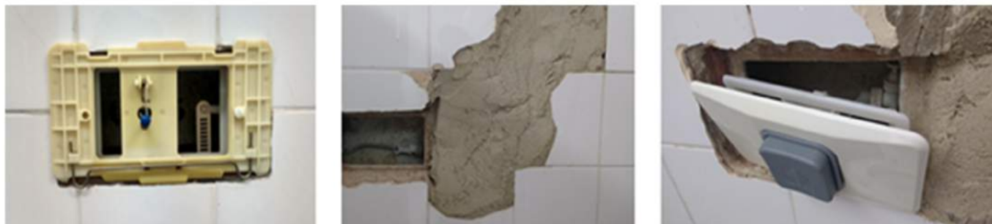
Figura 3: Sistema de acionamento danificado de caixa de descarga embutida. Fonte: arquivo pessoal dos autores.
